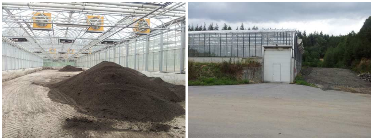
Abb. 25: Solare Trocknung in der Anlage in Passau: Gewächshaus mit Ventilatoren (links), gekapselter Abwurf für das Outputmaterial (rechts)
