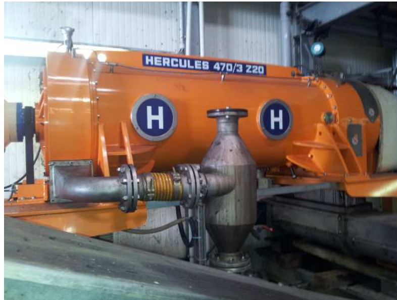
Abb. 26: Dekanter in der Anlage in Passau
