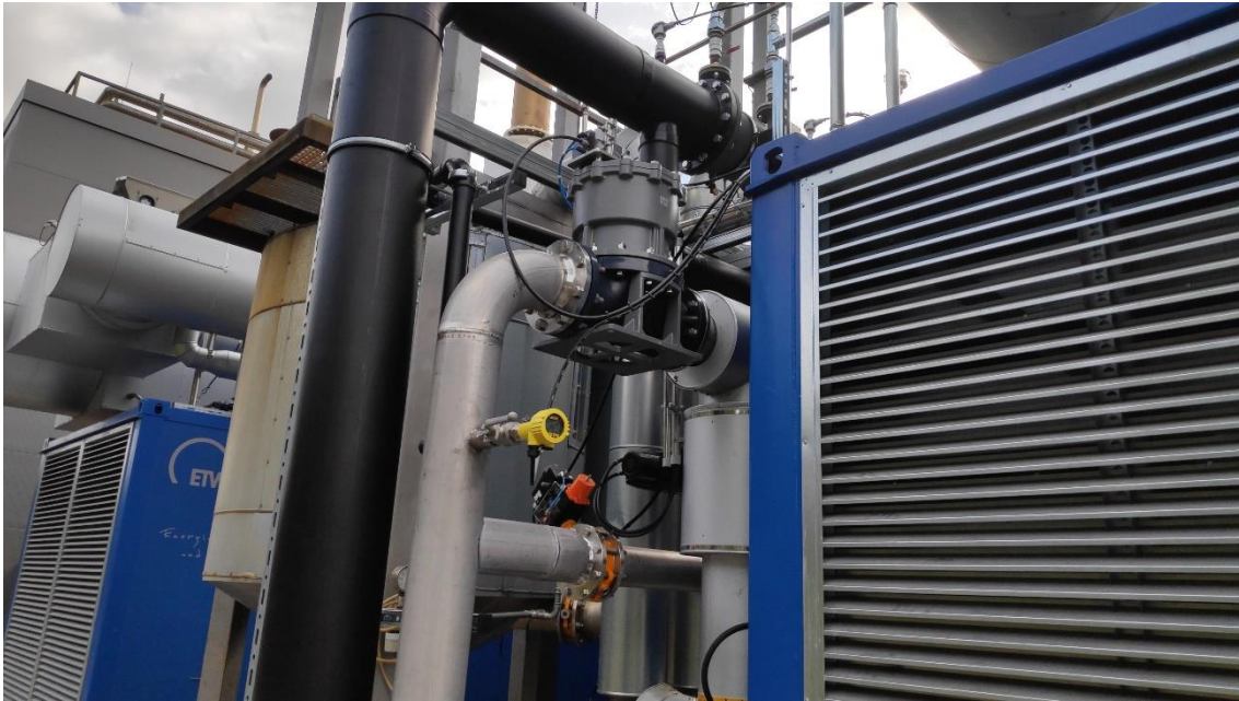
Abb. 3: Foto vom Membranventil mit Bypass zur Biogaspendingung auf der Seite des BHKW
