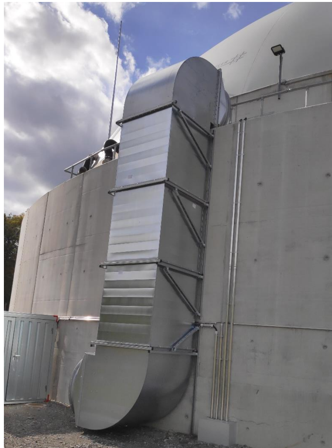
Abb. 10: Foto von der Bewetterungsseite des FD-Speichers 3
