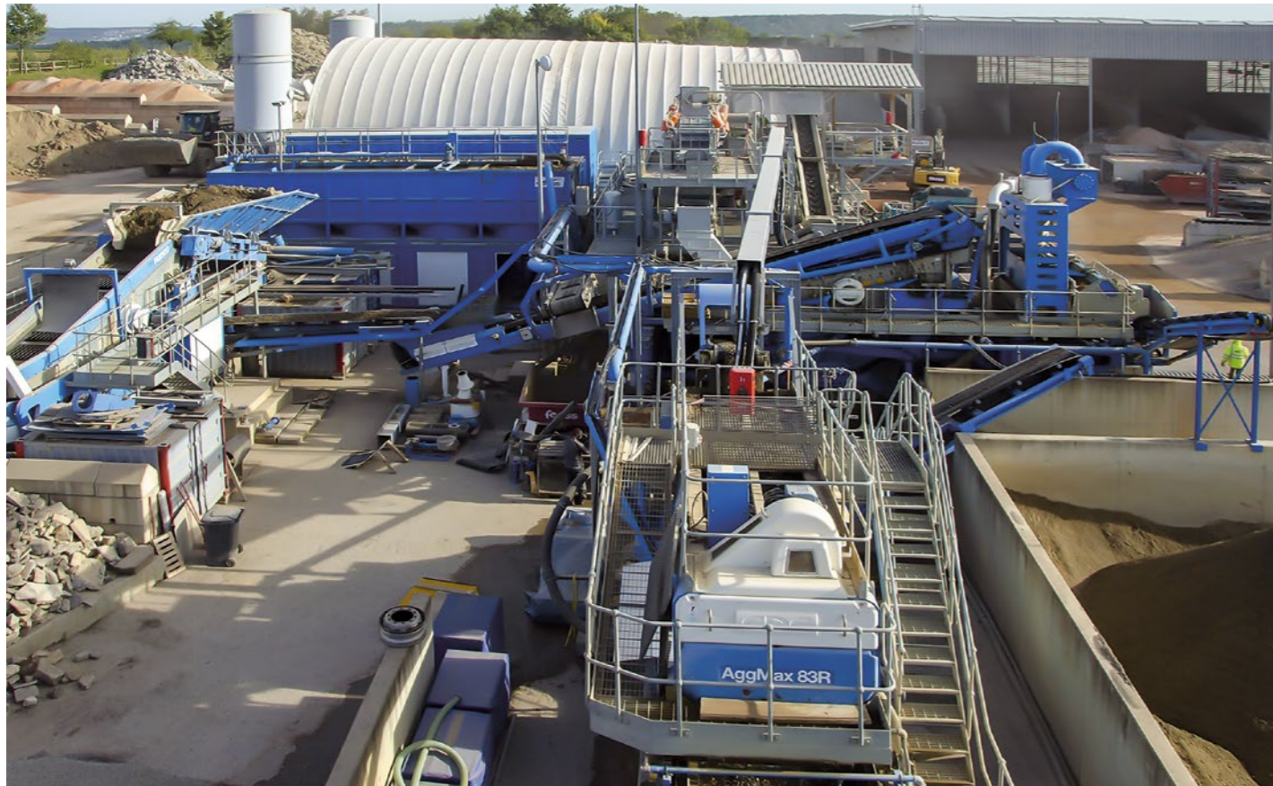
Anlage zur Aufbereitung von Bodenaushubmassen mittels Schwertwäsche und Nassklassierung © feess
