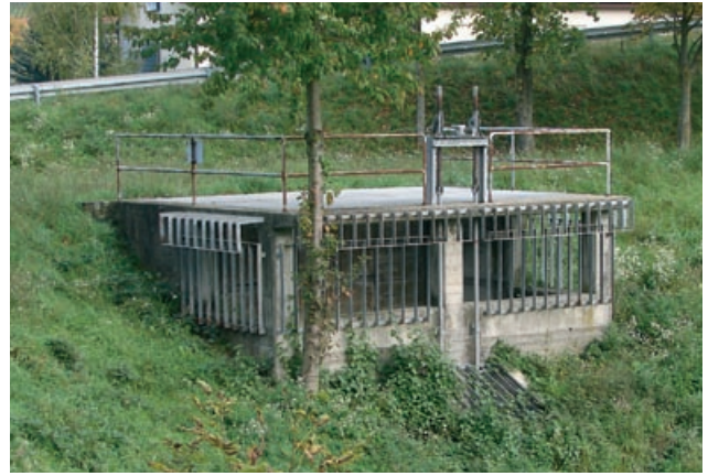
Abb. 4.73: HRB Breitschen, Rechen vor der Stirnentlastung (Versetzungsgefahr), Ebringen
