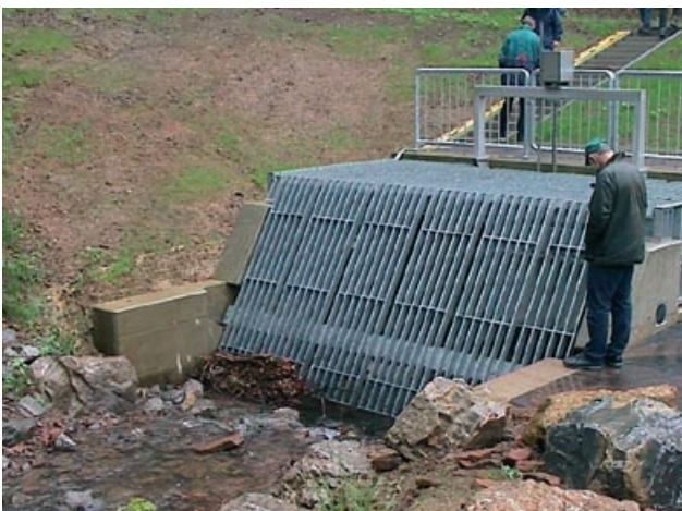
Abb. 4.61: HRB Haager Tal, Einlaufrechen mit Schieber (wasserseitig), Schönbrunn
