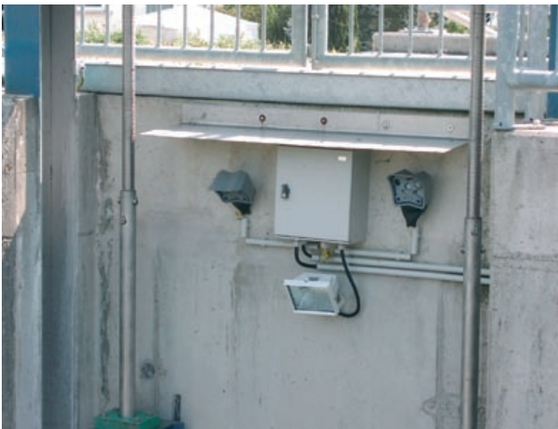
Abb. 4.110: Beleuchtung und Überwachungskameras
