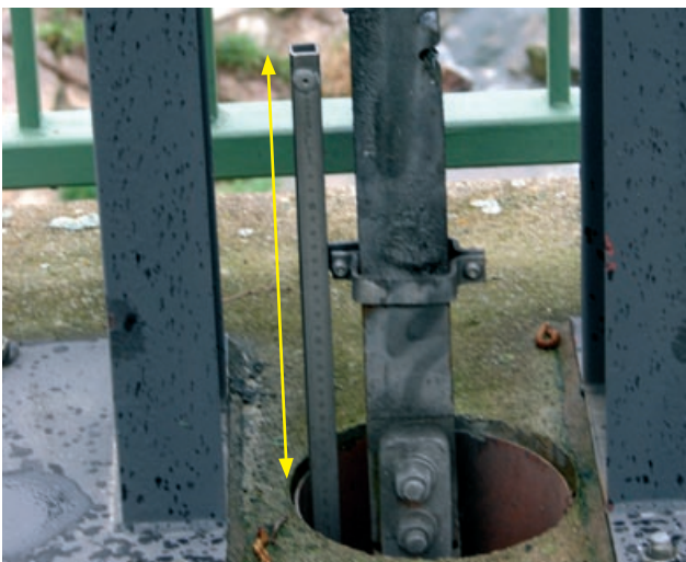
Abb. 4.101: Montiertes Metermaß zur Ablesung der Schieberöffnung
