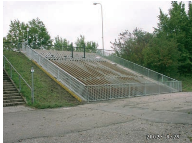
Abb. 4.48: HRB Neckarsulm, Rechen vor Heberentlastung, Neckarsulm
