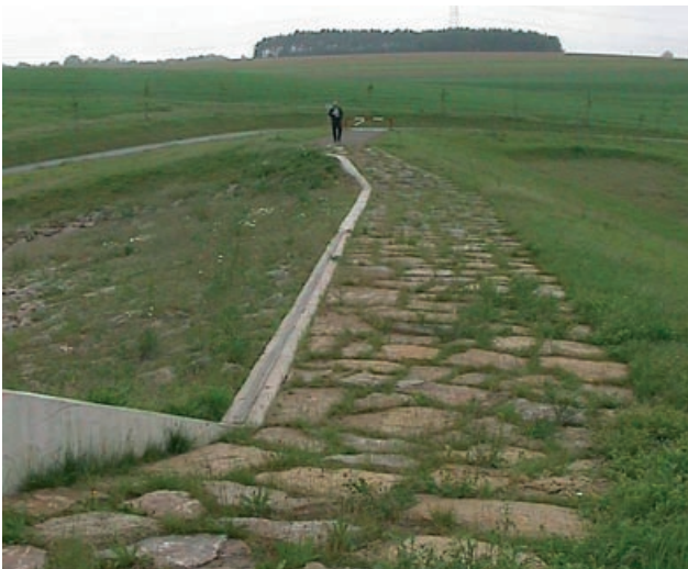
Abb. 4.26: HRB Gewesterbach, abgesenkter Überlaufbereich, Buchen
