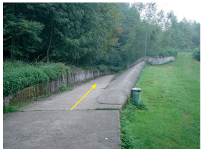
Abb. 4.41: HRB Katzenbach, Überlaufschwelle mit Weg als Flutmulde, Pfaffenhofen
