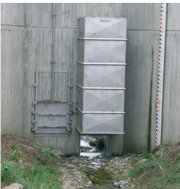
Abb. 4.57: HRB Apfelbach, schwimmergesteuerter Schieber (unter der Abdeckung), Affalderbach
