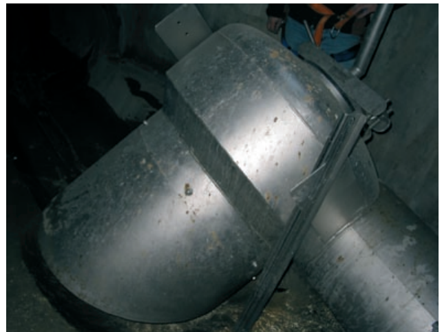
Abb. 4.58: HRB Laire, Wirbeldrossel, von rechts Zufluss, Auslass nach unten, Bötzingen
