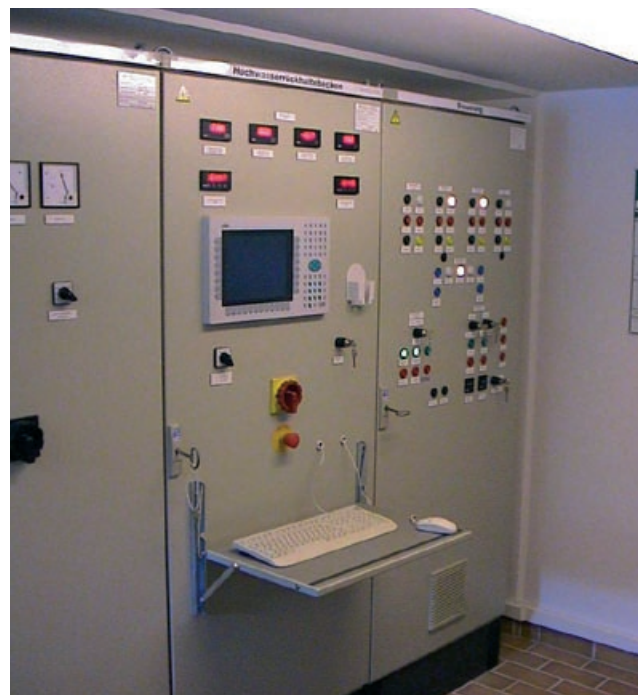
Abb. 4.98: HRB Bernau, Steuer- und Regeltechnik, Neckarbischofsheim
