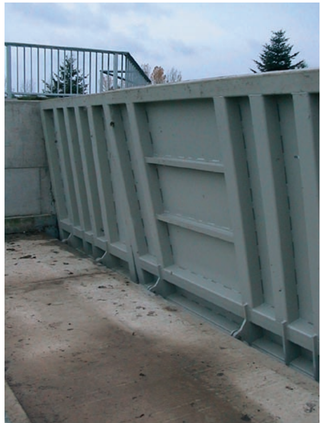
Abb. 4.14: HRB Wiesentalpolder S 63, oben Hochwasserschutzwände beginnen aufzuklappen, unten Hochwasserschutzwand im Detail, Sinsheim
