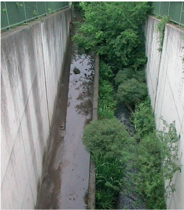
Abb. 4.56: HRB Ellbach, links Betriebsauslass, rechts Ökogerinne mit dichter Vegetation, Ellhofen
