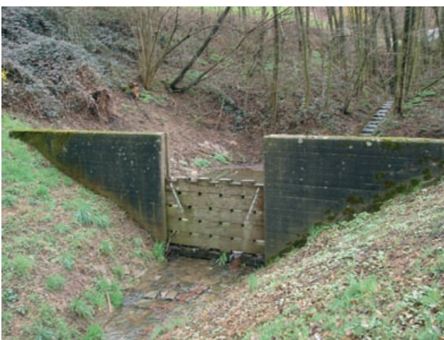
Abb. 4.106: HRB 13, Geschiebesperre in einem steilen Rebflureinzugsgebiet, Bühl
