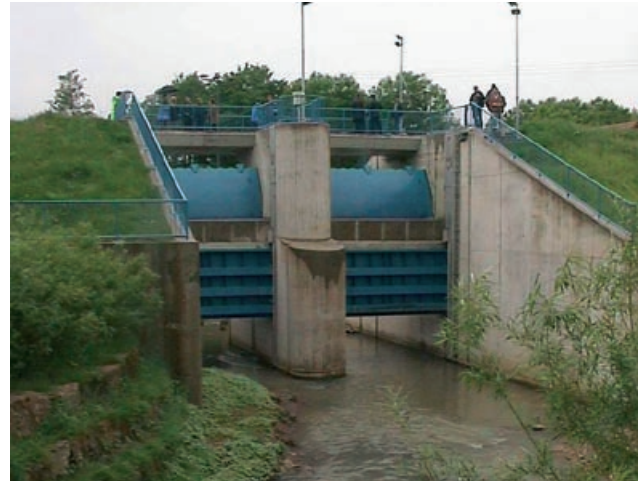
Abb. 4.22: HRB Waibstadt-Bernau, HWEA im Durchlassbauwerk mit Fischbauklappe, Neckarbischofsheim
