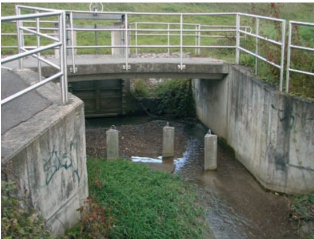
Abb. 4.94: HRB Untere Niedermatten, Strahlaufreißer unterhalb des Durchlasses, Vogtsburg im Kaiserstuhl
