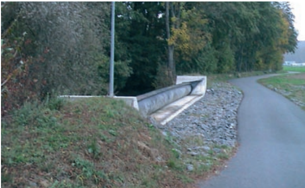
Abb. 4.77: HRB Wiesentalpolder bei Sinsheim, Schlauchwehr als Regelungsbauwerk des Einlauf, Sinsheim
