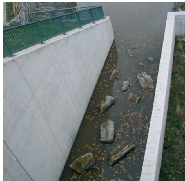
Abb. 4.92: Störsteine zur Energieumwandlung im Betriebsauslass
