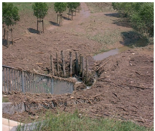
Abb. 4.64: HRB Wollenberg, Palisadenrechen mit guter Wirkung, Rappenaу
