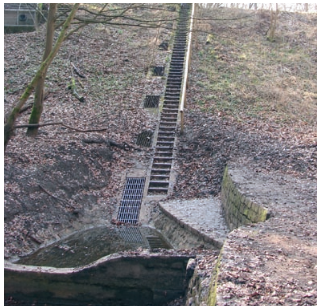
Abb. 4.68: HRB Schwäblesklinge, Einlaufrechen entlang der Treppe bis zur Krone, Stuttgart
