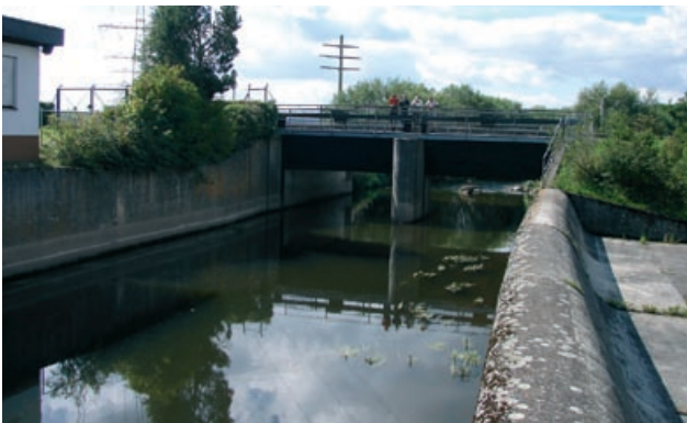
Abb. 4.79: HRB Marbach, rechts Überlaufschwelle, im Gewässer zwei Schütztäfel zum Regeln des Wasserstandes, Villingen-Schwenningen
