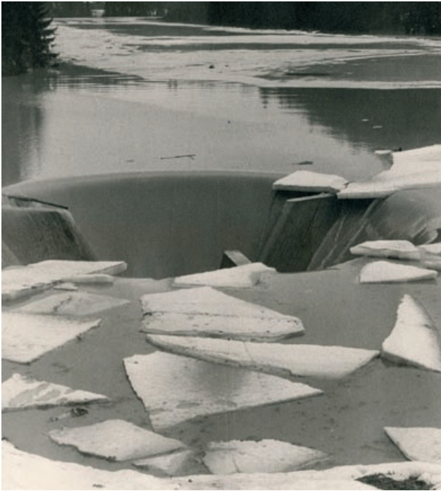
Abb. 4.47: HRB Beimbach, Einlauftrichter im Hochwasserfall bei Eisgang, Rot am See
