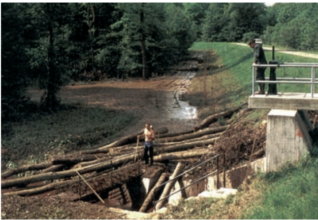
Abb. 4.71: Im Stauraum abgelagerte Baumstämme verklausen den Einlauf
