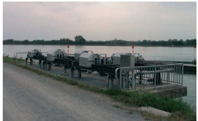
Abb. 4.75: Rückhalterium Söllingen/Greffern Einlaufbauwerk mit Schieberantrieb, Lichtenau
