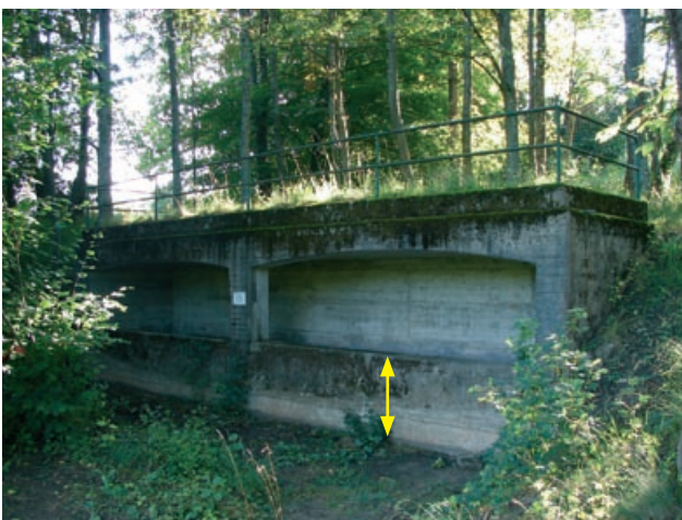
Abb. 4.32: HRB Lehenbach, älterer Sammeltrög (eckige Überlaufkante), Winterbach
