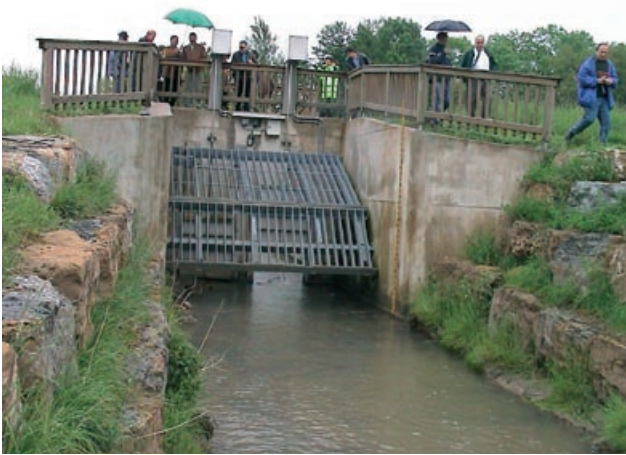
Abb. 4.65: HRB Raußmühle, Räumlicher Grobrechen, Eppingen
