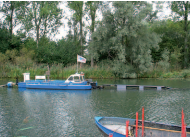
Saugbagger im Eggensteiner Altrhein: Ein Saugkopf am Ende der in der rechten Bildhälfte erkennbaren Rohrleitung nimmt den Schlamm auf. Über eine flexible Rohrleitung, links im Bild zu sehen, wird der Schlamm auf ein Spülfeld befördert.
