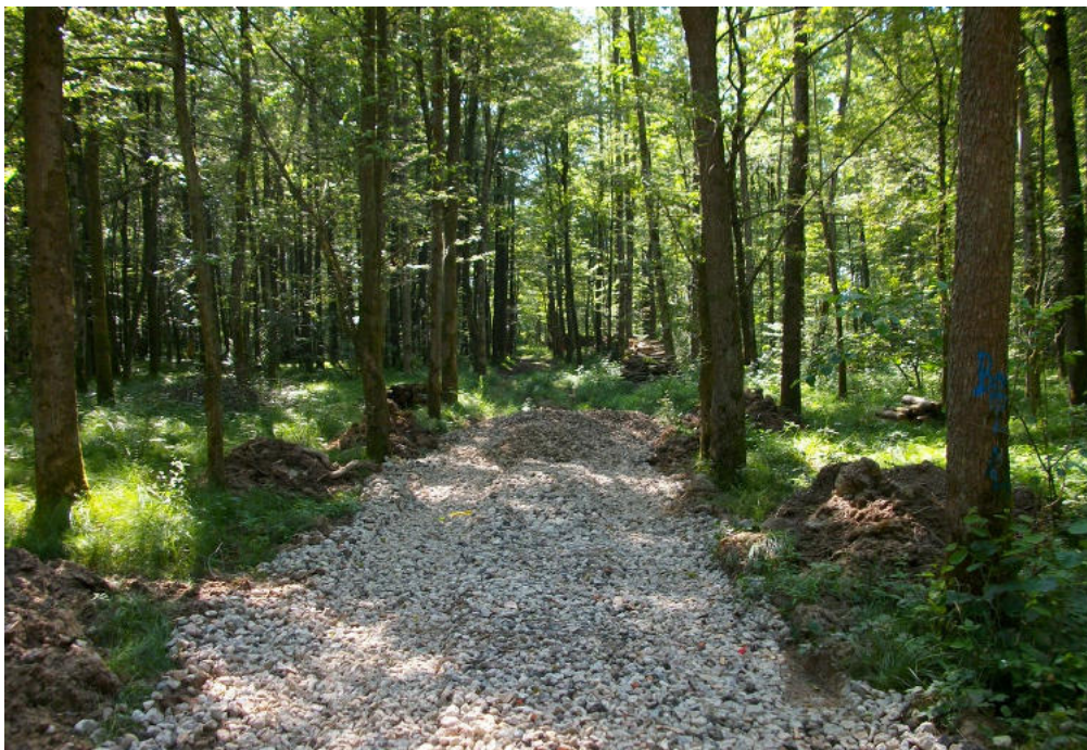
Bild 43: Im Sommer frisch verfüllte Wegeinmündung. Notwendige Sanierungen, z. B. nach Rückmaßnahmen, sollten grundsätzlich außerhalb der Aktivitätsphase der Gelbbauchunke durchgeführt werden. Dabei sollten im Umfeld Ersatzgewässer angelegt werden, damit die Gelbbauchunke ( Bombina variegata ) [1193] zumindest für einige Jahre diesen Bereich weiterhin zur Fortpflanzung nutzen kann.
