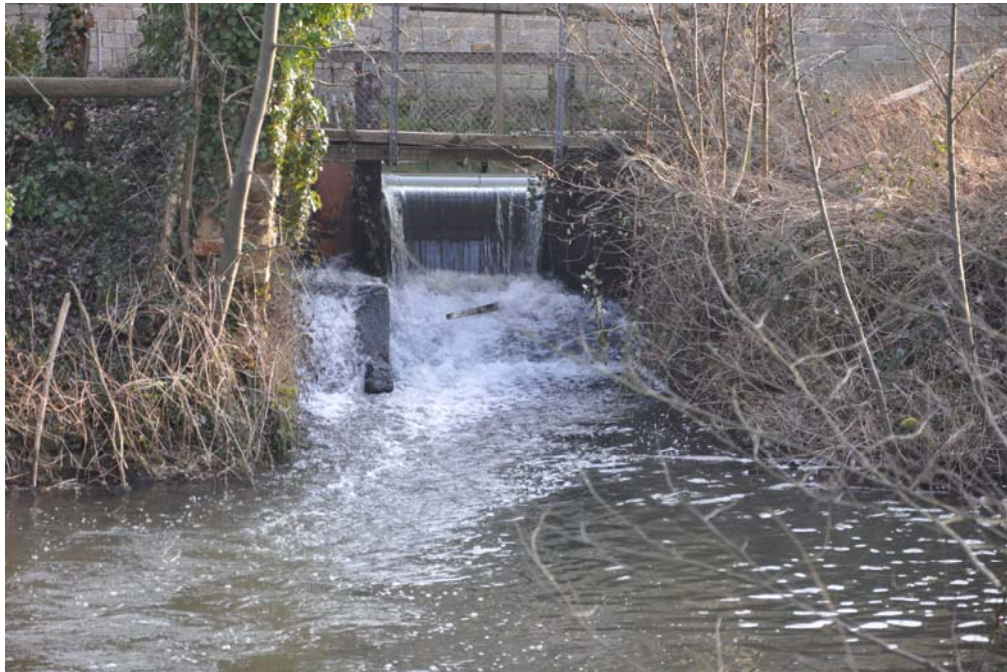
Bild 17: Das Wehr an der Heckenmühle am Mühlbach bei Söllingen als Migrationshindernis Frank Pätzold, 07.02.2010
