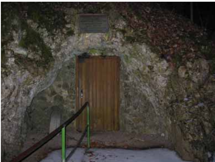
Bild 24: Ansicht des Einganges der Charlottenhöhle. Er ist hermetisch verschlossen und behindert eine gute Bewetterung (Nagel, A., 03.02.2009)
