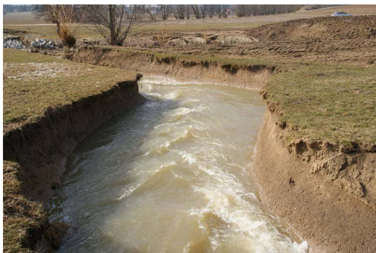
Bild 26: Renaturierter Abschnitt der Schneidheimer Sechta mit Kastenprofil nach dem ersten Hochwasser (unmittelbar oberhalb der Einmündung Edelbach). Foto: K. Böger, 18.03.2010
