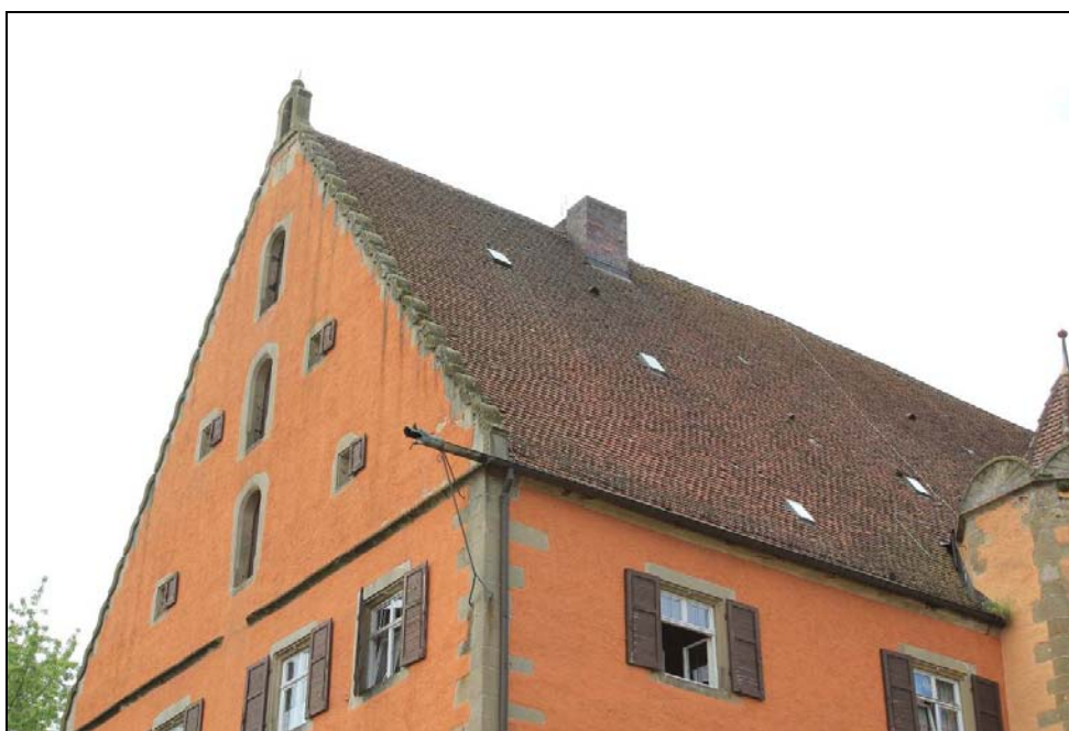
Bild 20: Östlicher Teil des sog. „Erasmusbau“ des Obersontheimer Schlosses, vom Schlosshof aus gesehen: Der Haupthangplatz der Mausohrkolonie befindet sich in den Sparrenfeldern rechts des Kamins. In der Giebelwand sind die drei Türöffnungen zu sehen, die vermutlich als Ausflugsöffnung genutzt werden
