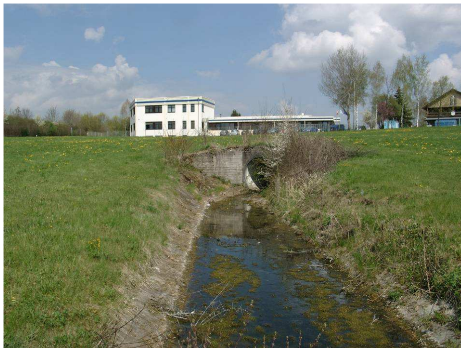
Bild 39: Mischwasserentlastung aus dem Gewerbegebiet Ingersheim in den Tümpfelbach, Lebensstätte der Groppe. Th. Bobbe, 27.06.2010
