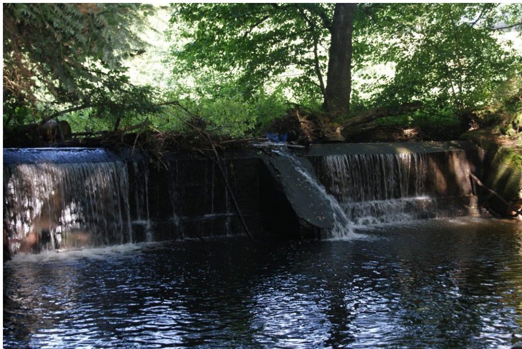
Bild 10: Beeinträchtigung der Durchgängigkeit des Fließgewässers Blinde Rot. Stauwehr zur Ableitung des ehemaligen Mühlgrabens zur Burghardsmühle, der oberhalb des Staus abgeleitet wird. K. Böger, 06.09.2012
