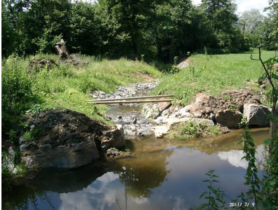
Bild 19: Einlauf des Umgehungsgerinnes des Rohrmühlenwehres an der Ohrn. Durch diese Maßnahme wurde die Durchgängigkeit des Gewässers an dieser Stelle wiederhergestellt.
