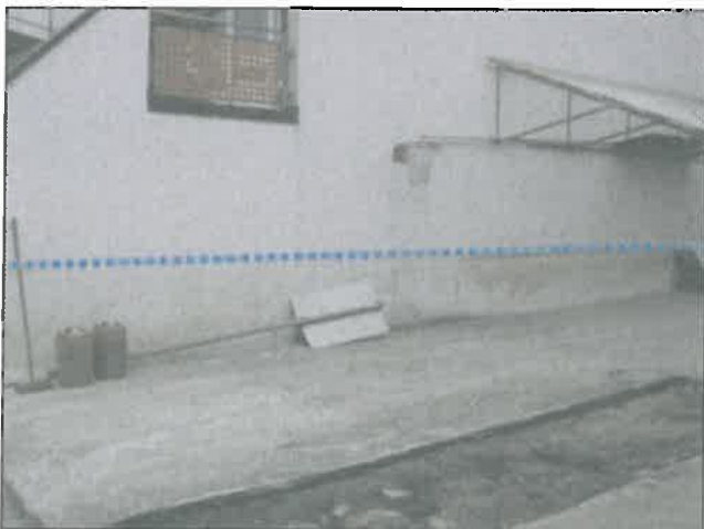
Abb. 1.21: Beispiel Verschmutzung an Bauwerken.
