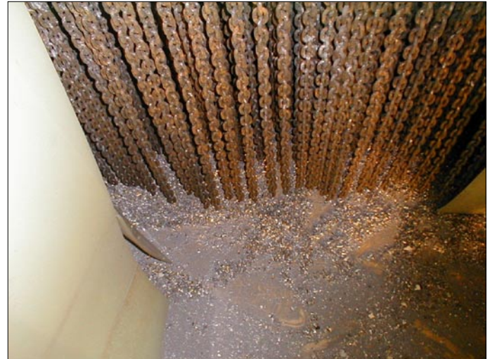
Bild 4: Kettengeschossfangkammer nach dem Ende des Schießbetriebes (deutlich sichtbare Metallstaub-Ablagerungen)
