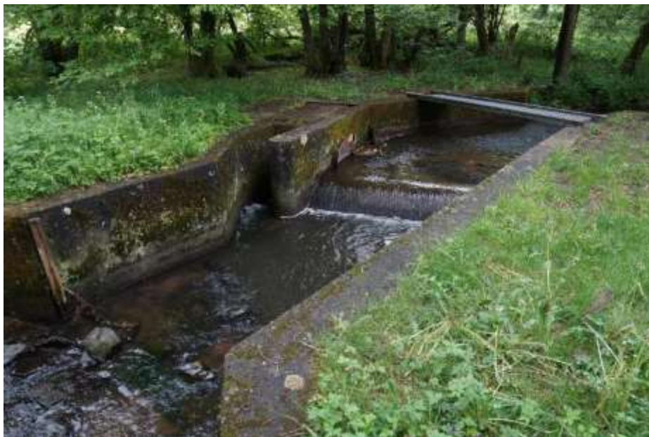
Bild 9: Fließgewässer mit flutender Wasservegetation [3260], Wehranlage in Betonbauweise als starke Beeinträchtigung im Elzbachabschnitt östlich Laudenberg Klaus-Bernhard Kühnapfel, 30.05.2017
