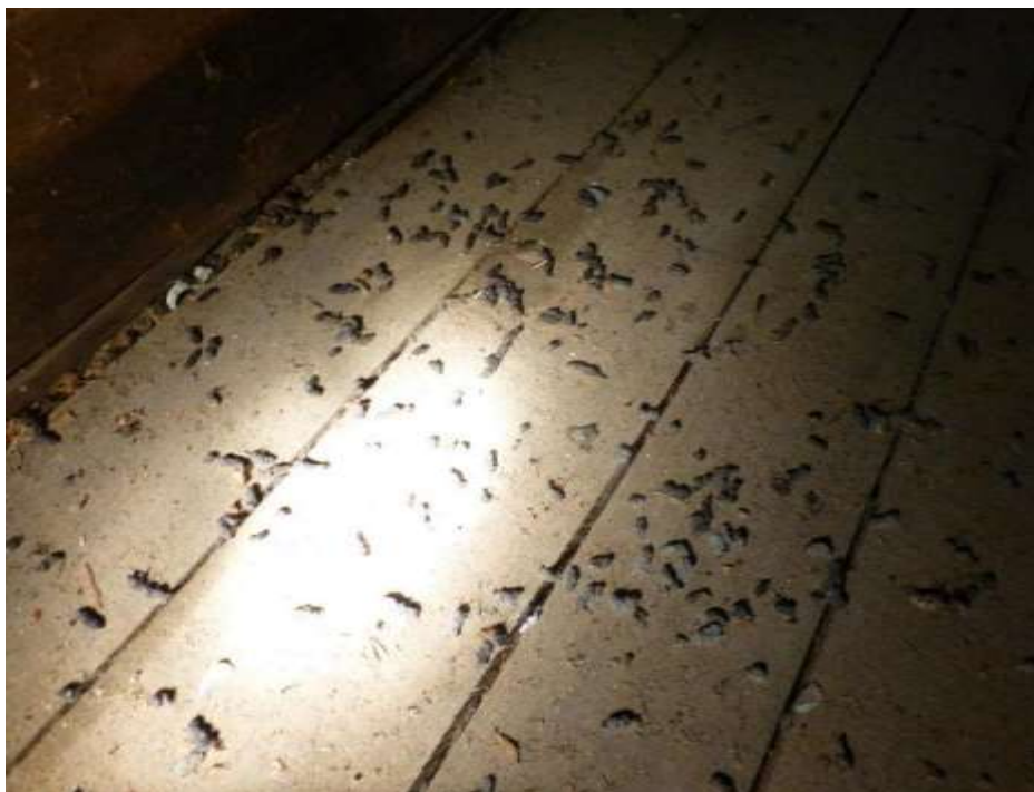
Bild 70: Großes Mausohr ( Myotis myotis ) [1324], Mausohrkot im Dachstuhl der Katholischen Kirche Fahrenbach Peter Endl, 21.07.2017
