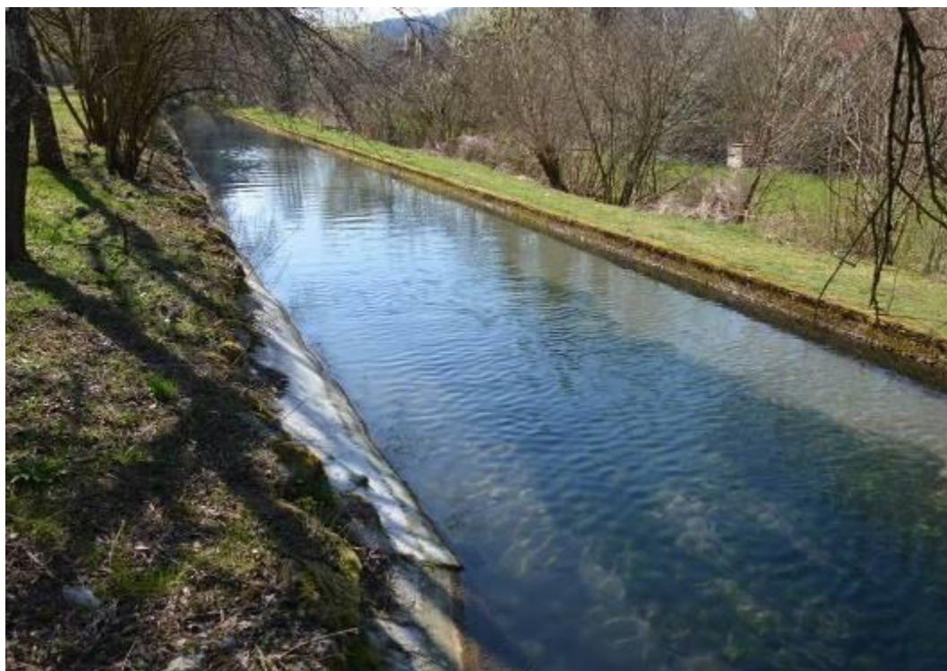
Bild 51: Kraftwerkskanal bei Hütten. Frank Pätzold, 30.03.2017
