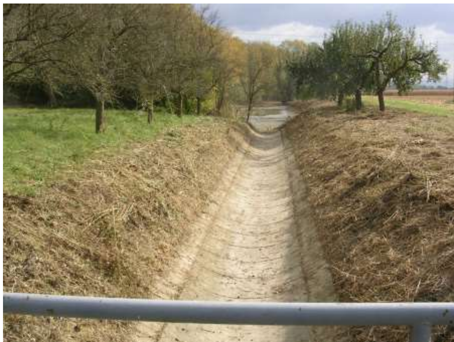
Abbildung 89: Scheidtgraben bei Illingen nach einer Räumung (F. Pätzold, 06.10.2009).
