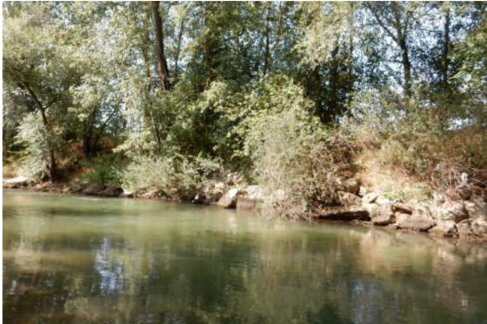
Bild 3: Beeinträchtigung der Gewässerstruktur an der Tauber: Uferbefestigung mit Blockbausteinen in einem Abschnitt nördlich Gerlachsheim. K. BECK, 28.08.2018
