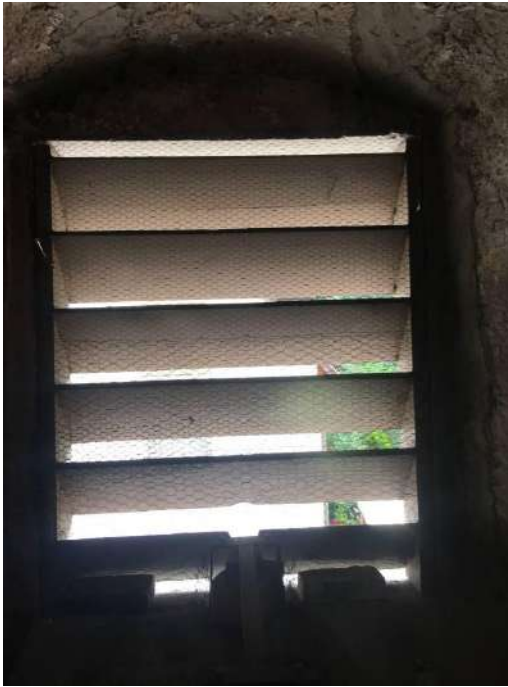
Bild 57: In der evangelischen Kirche in Ispringen gibt es Anzeichen früherer Quartiernutzung durch Fledermäuse (Kot); durch Vergitterung von Einflugsöffnungen (wie hier im Bild den Schallluken im Glockenturm) mittels Sechseckgeflecht ("Hasendraht") zur Taubenabwehr ist dies derzeit nicht mehr möglich. Als Maßnahme außerhalb des FFH-Gebietes mit Bedeutung für das FFH-Gebiet sollten wieder fledermausgerechte Einflugmöglichkeiten geschaffen werden. Rolf Klein, 28.07.2016, Evangelische Kirche Ispringen
