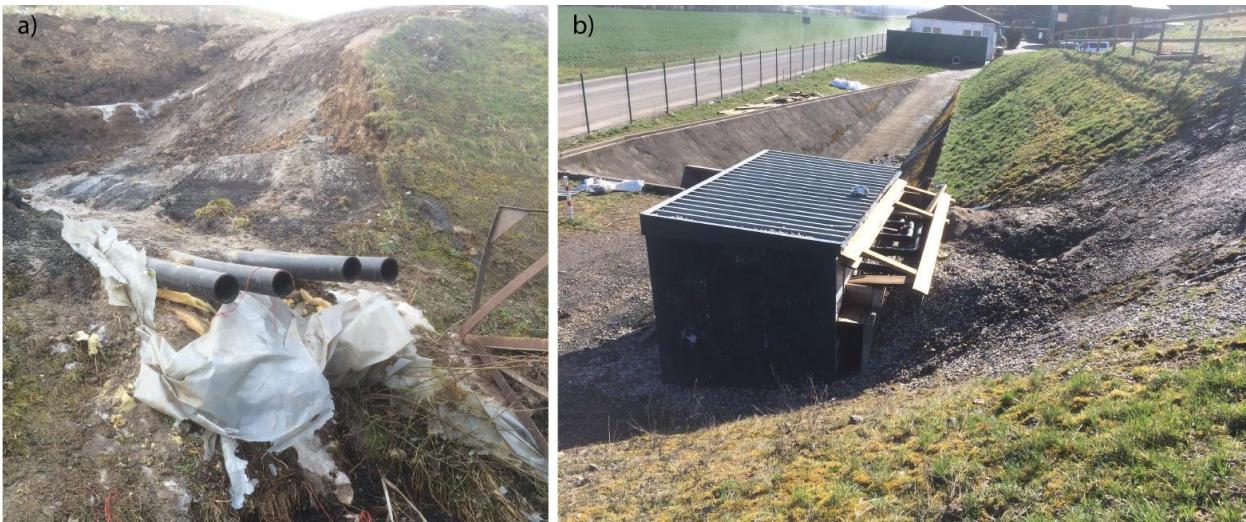
Abb. 6: a) Zulaufrohre mit Durchbiegung im Hangbereich, b) Fertiggestelltes System, ohne Isolierung.
