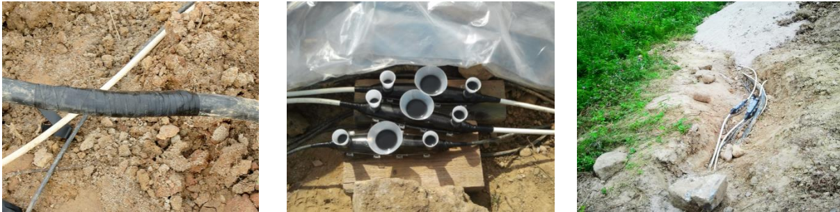
Bild 3.4: Defekte an Spannungsversorgungskabel (links) und Reparatur der gekappten Kabel (Mitte/rechts). Diese Kabel verlaufen an der Stelle etwa 10 bis 20 cm unter der Erdoberfläche.
