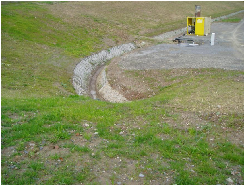
Bild 15: Mobile Entgasungsanlage am Fußpunkt im Eingangsbereich der Deponie
