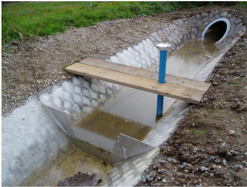
Bild 13: Messwehr zur Ermittlung der abfließenden Oberflächenwassermengen
