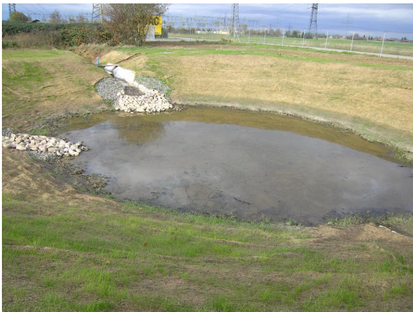
Bild 10: Absetzbecken II nach Inbetriebnahme des Beckens
