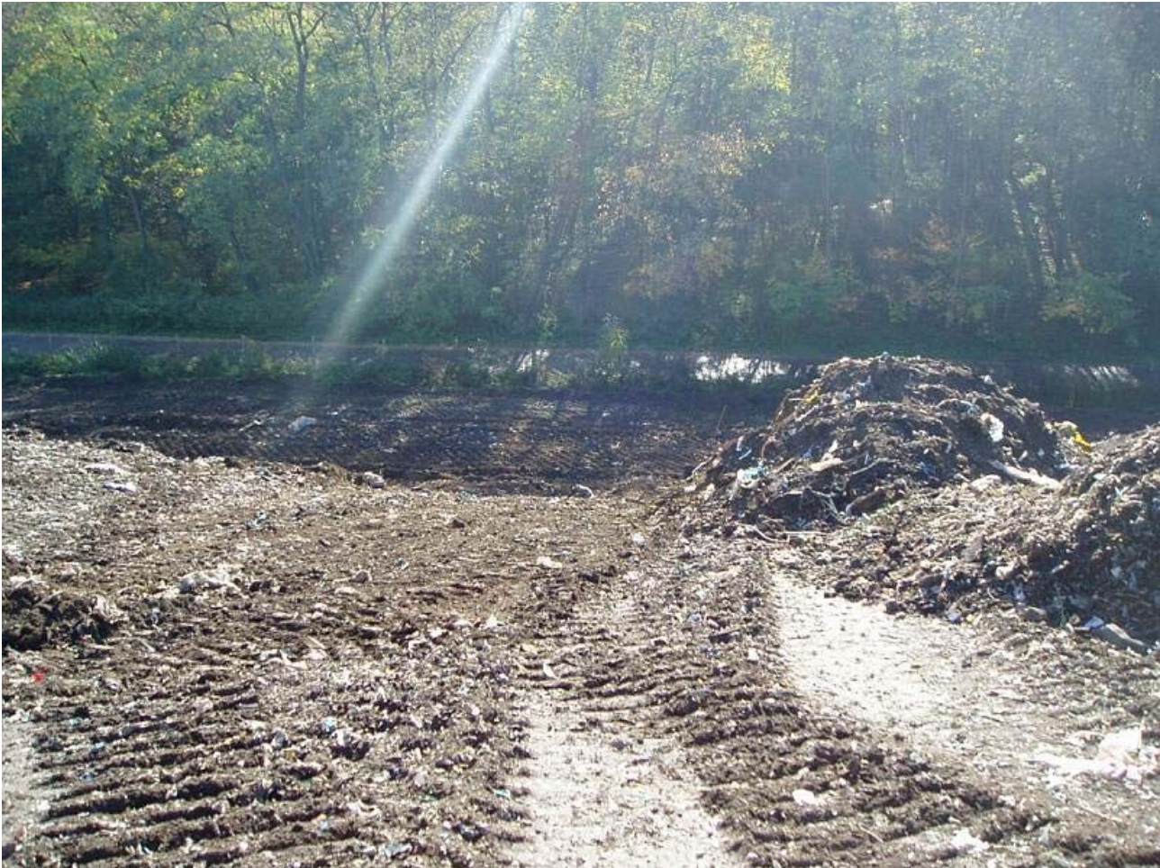
Bild 14: Abfallumlagerung an der Südböschung im Ostteil
