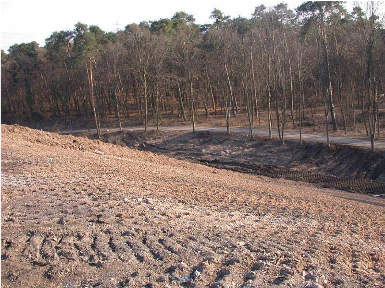
Bild 8: Südrand im Bereich der Kurve nach der Rodung bzw. Abfallumlagerung
