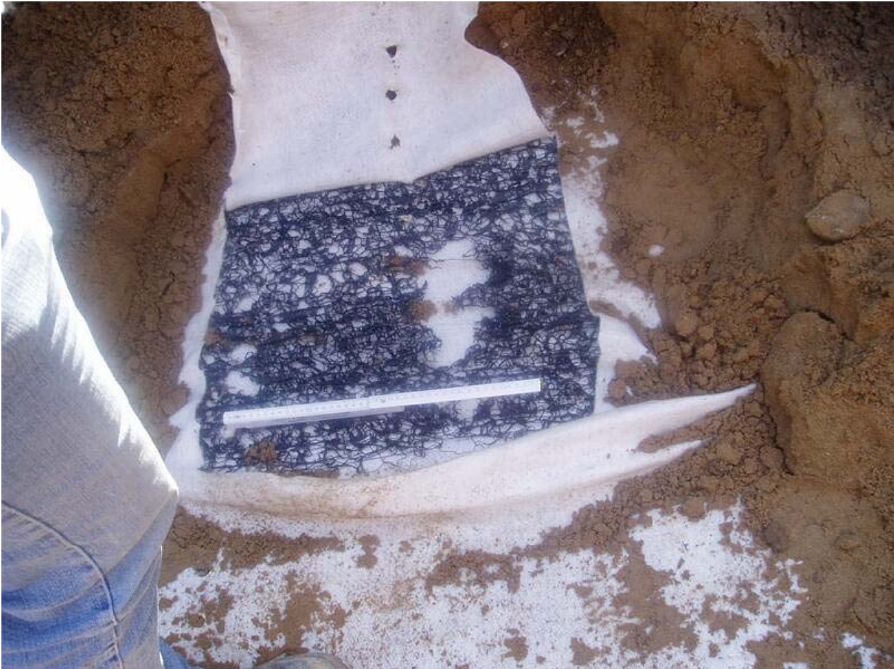
Bild 18: freigelegte Drainmatte beim Testfeld im Bereich mit aufgetretenen Verformungen
