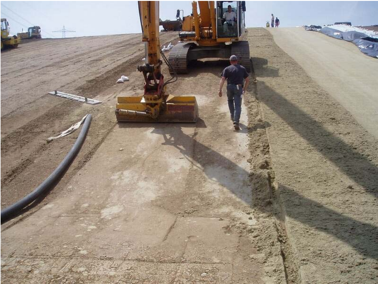
Bild 4: Vor dem Einbau der Trisoplastschicht wird die Ausgleichsschicht mit dem Baggerlöffel geglättet
