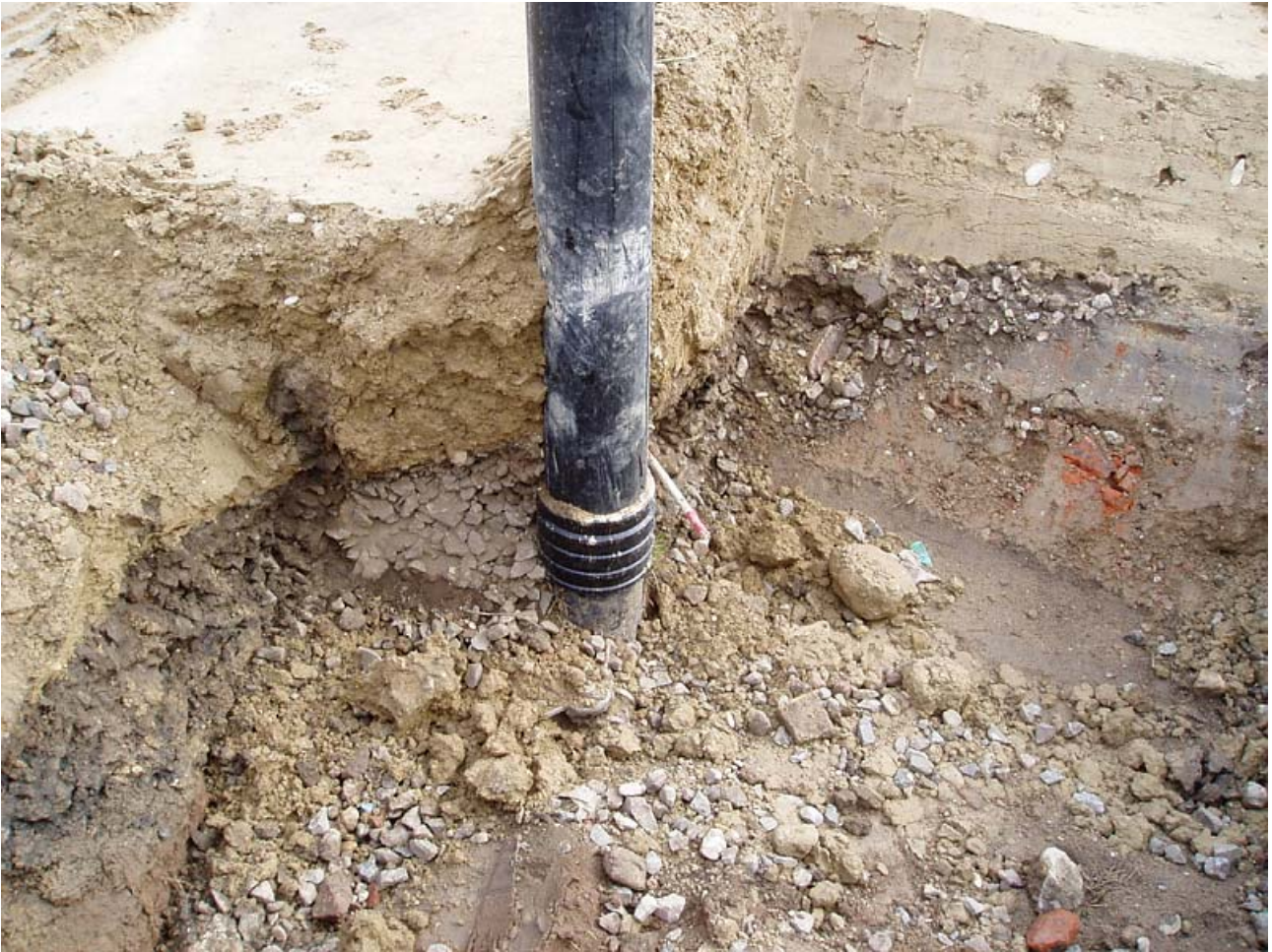
Bild 3: Verlängerung von vorhandenem Gasbrunnen
