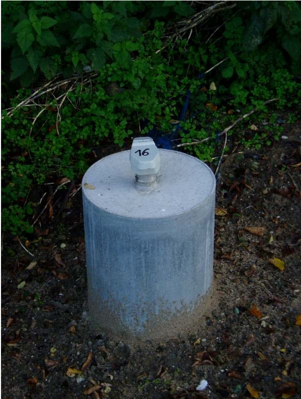
Bild 20: Gaspegel am Deponierand mit Abdeckkappe
