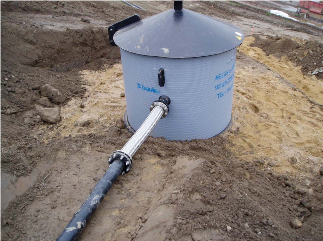
Bild 4: Gasbrunnenkopfschacht über dem Gasbrunnen
