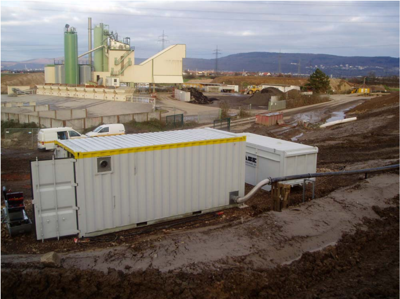
Bild 6: temporäre Entgasungsanlage in der Bauphase der Deponie Durchsatzleistung bis 500 m 3 /h
