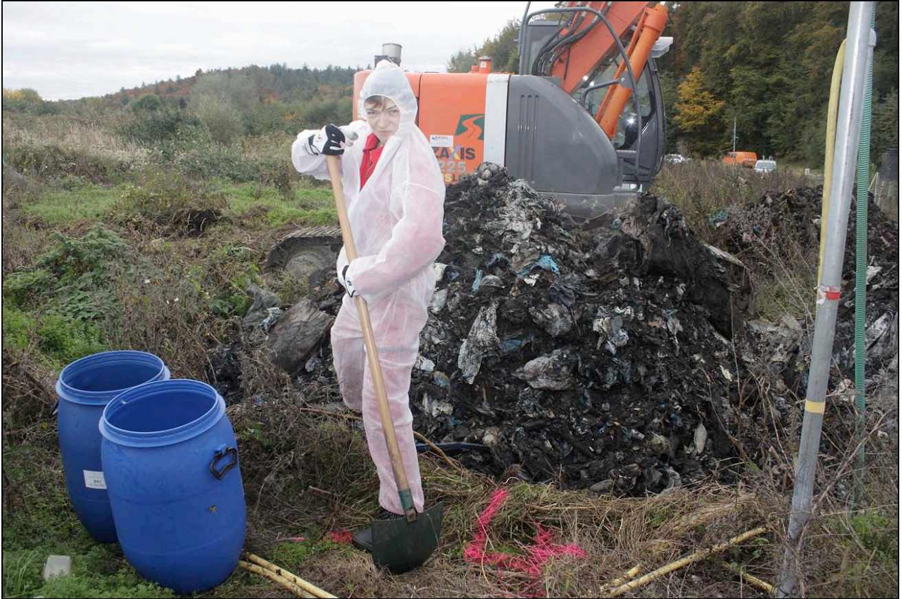
Abbildung 4 Beprobung eines Haufwerks mit spitzer Frankfurter Schaufel; in rosa die Angabe des entsprechenden Tiefenmeters
