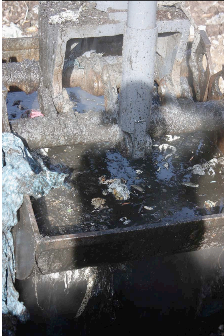
Abbildung 7 Abfallprobe mit eingestautem Wasser aus BS2
